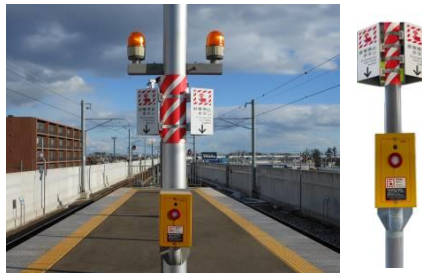
〈列車非常停止警報装置〉
