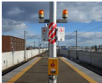
〈列車非常停止警報装置〉
