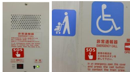
〈非常警報装置〉
