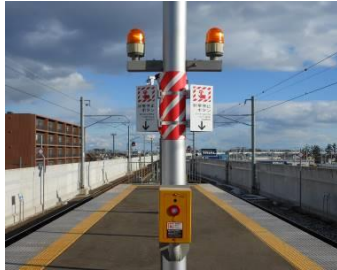
〈列車非常停止警報装置〉
