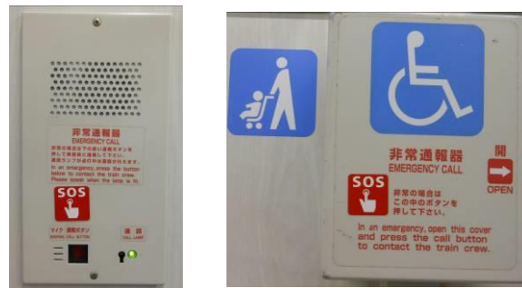
〈非常警報装置〉
