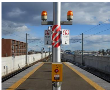
〈列車非常停止警報装置〉
