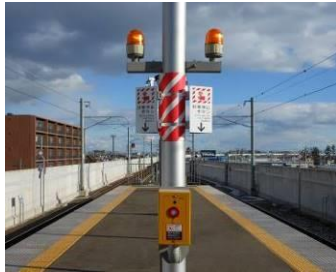
〈列車非常停止警報装置〉
