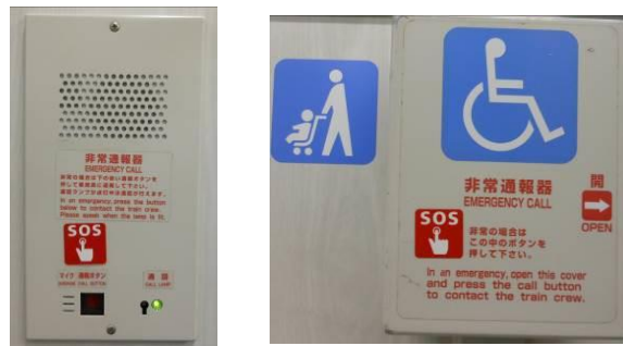
〈非常警報装置〉
